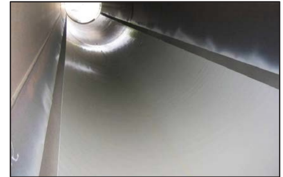
Aplicación final sólo a la parte inferior de la tubería donde el condensado crea graves problemas de corrosión.
