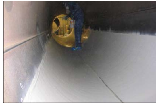
Aplicación de la ARC S4 + completada usando un equipo de pulverización libre de aire.
